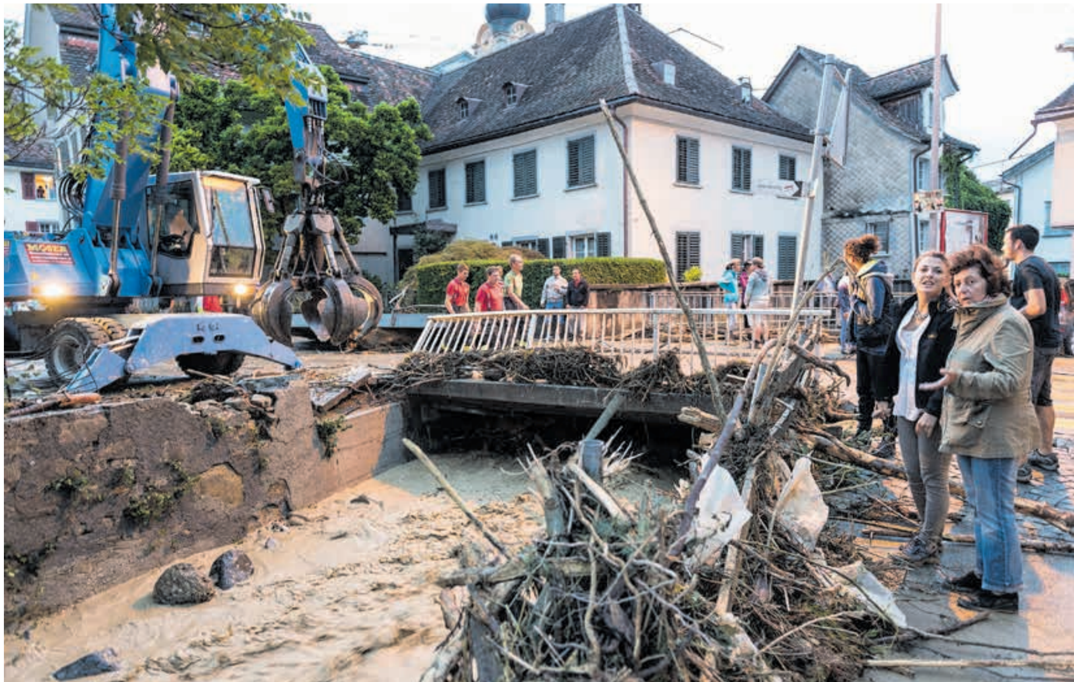
2014 verwandelte sich der Dorfbach in Altstätten innert Minuten in eine reissende Flut.
